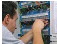
Die Sonnenbatterie speist Strom auf allen drei Phasen des Hausnetzes ein. Volthaus-Techniker Bastian Schmal schließt empfindliche Verbraucher an die unterbrechungsfreie Stromphase L1 an, damit es beim Umschalten zwischen Batterie- und Netzbetrieb keine Probleme gibt. Foto: Solarpraxis AG/Mirco Sieg
