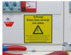
In einem Haus, das sich mittels Speichersystem selbst versorgt, müssen bei Wartungsarbeiten besondere Sicherheitsvorschriften beachtet werden. Foto: Solarpraxis AG/Mirco Sieg
