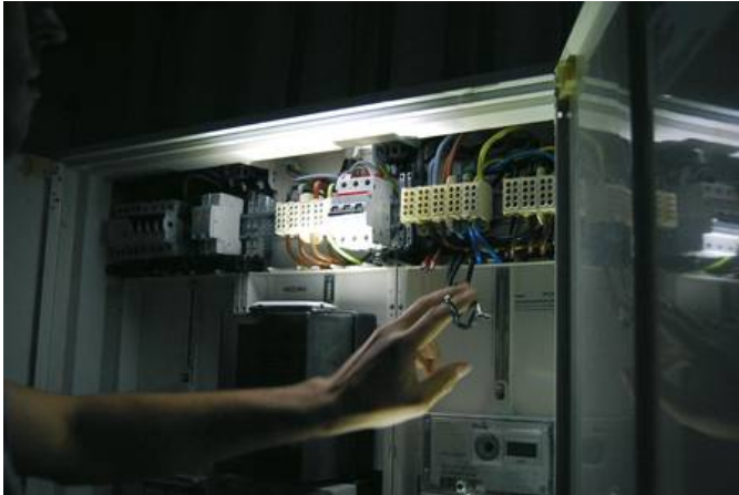
Die Einbindung des Speichersystems in den Stromkreis des Wohnhauses findet im Schein einer Taschenlampe statt. Für diesen Arbeitsschritt wird die Hauptsicherung des Gebäudes abgeschaltet. Foto: Volthaus/Christoph Kempf
